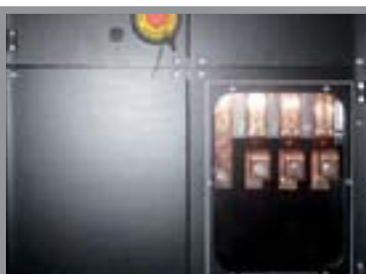
Acceso a bornero de conexión
