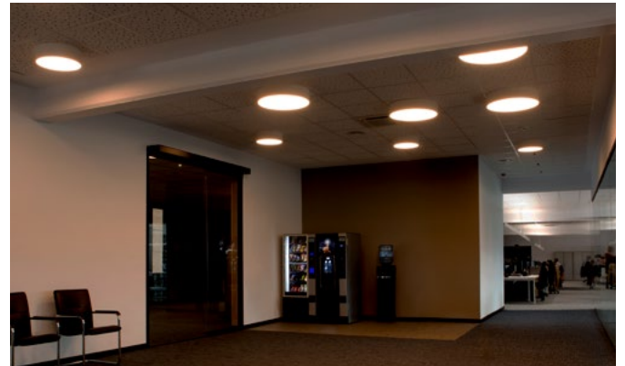
Sin presencia, luminosidad 25%. Sem presença, luminosidade 25%.
